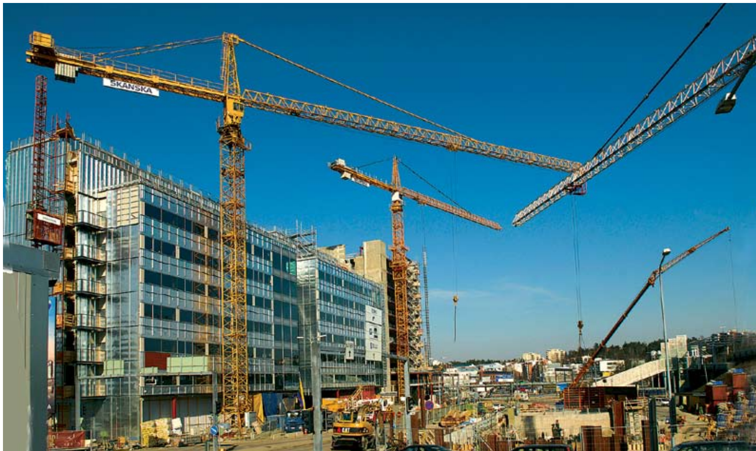
Panorama Towerin toimistotalojen ja Selloparkin työmaat sijaitsevat Espoon Leppävaarassa suuren Sello-kauppakeskuksen kupeessa. Panorama Towerin kiinteistöön kuuluu kaksi kahdeksan kerroksista ja yksi 17 kerroksinen toimistotorni. Työmaiden TR-indeksi on yli 96.
